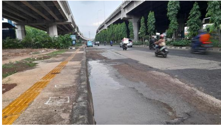
Gambar 1. Kerusakan Amblas Lokasi Penelitian
