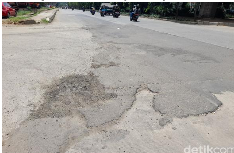
Gambar 2. Kerusakan Fatty Lokasi Penelitian
