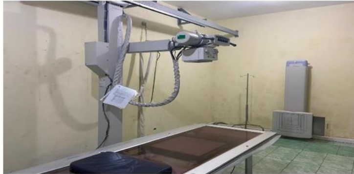
Gambar 7. Ruang Pesawat Konvensional (Instalasi Radiologi RSI Siti Aisyah Madiun, 2024)
