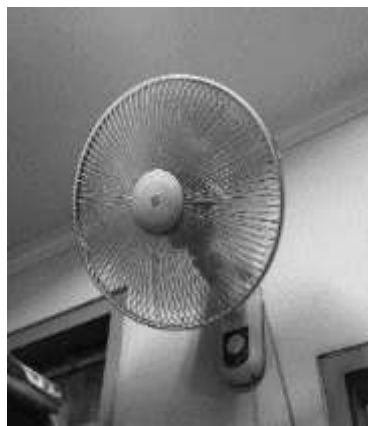
Gambar 3.2 Kipas Angin/Pendingin (Ruang Penyimpanan RM RSU Bina Sehat Bandung)
